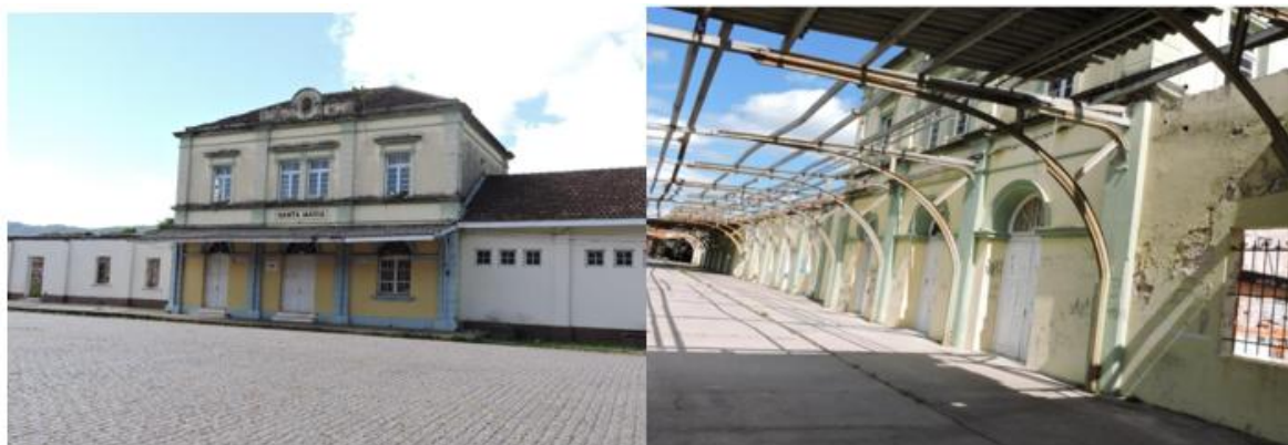
Figura 4 – Imagens incluindo a fachada da Gare e uma visão diagonal, datadas de 2019, destacando a falta de preservação do espaço público e o descaso da população.
