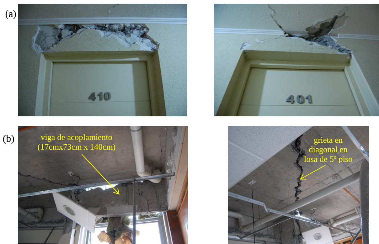
Figura 3: Daños en dinteles y losas de acoplamiento en Talca. (a) edificio habitacional de 20 pisos; (b) edificio público de 5 pisos.
