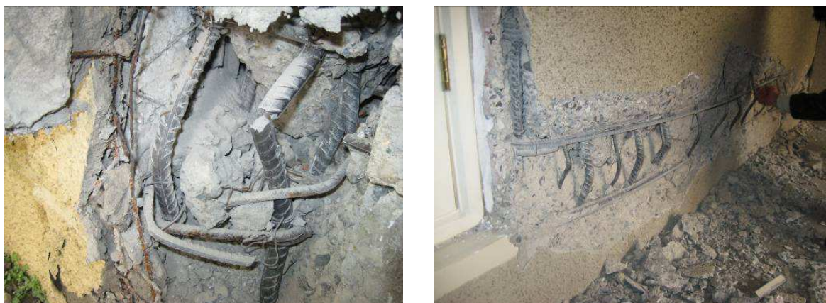
Figura 8: Pandeo y fractura de la armadura vertical en el borde y en el alma en una sección L conabertura.
