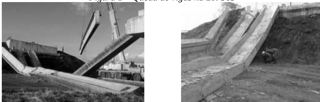
Figura 1 – Queda de vigas na BR-365
